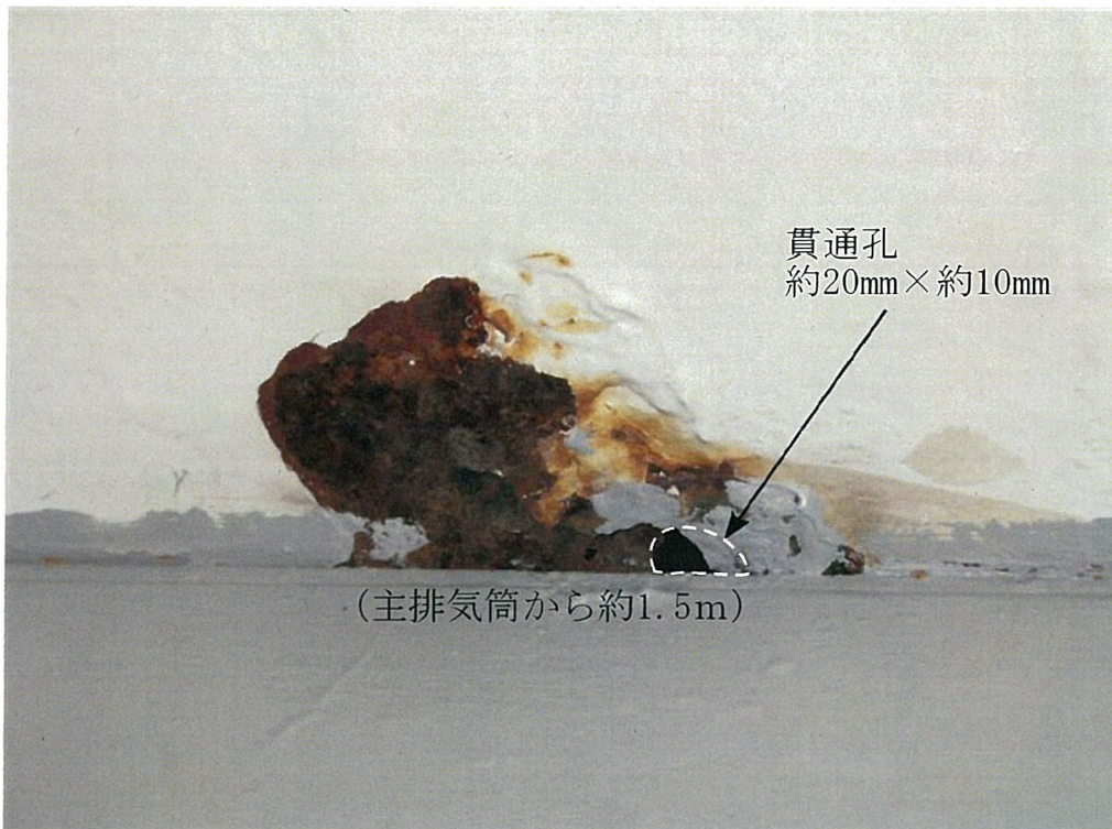
ダクト下部貫通孔の状況
